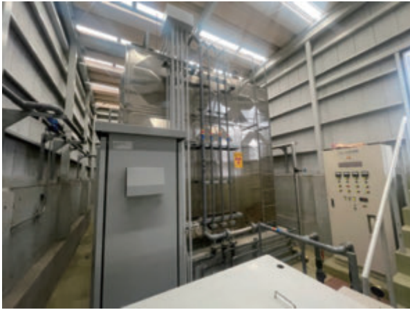
RI 施設排水設備
