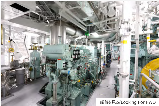
主発電機 Main Generator Engine
