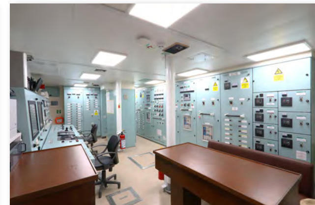
機関制御室 Engine Control Room
