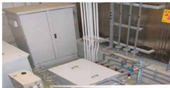
RI施設排水設備
