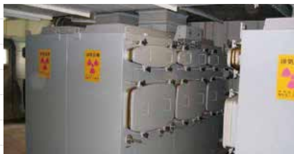
RI施設排気施設
