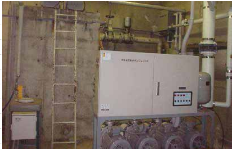
水再利用設備（中水設備）
