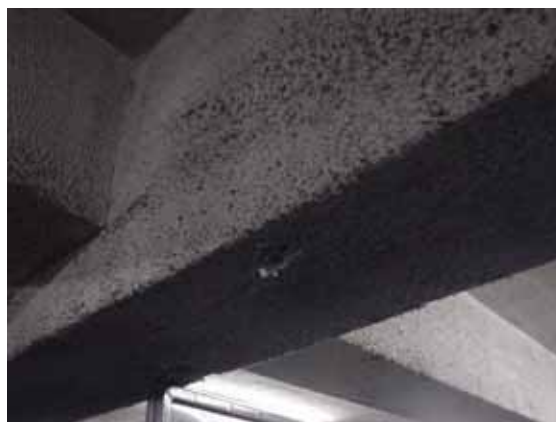
アスベスト吹付け状況 (梁、天井表面にアスベストが吹付けられています。)
