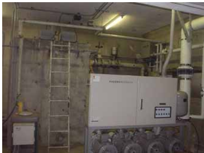
水再利用設備（中水設備）
