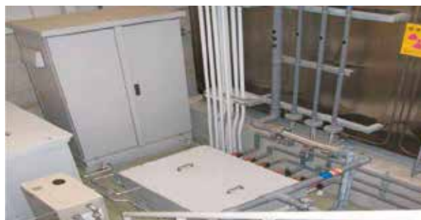
RI施設排水設備
