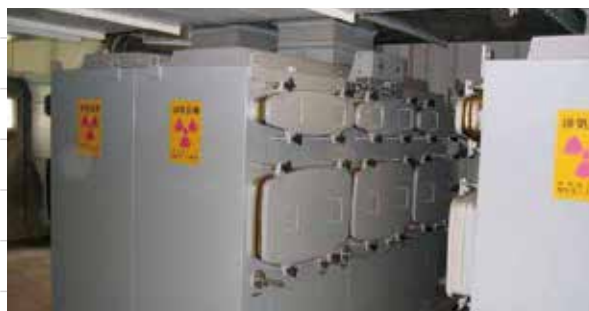
RI施設排気施設
