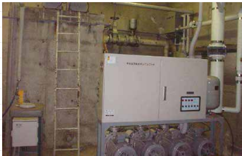
水再利用設備（中水設備）
