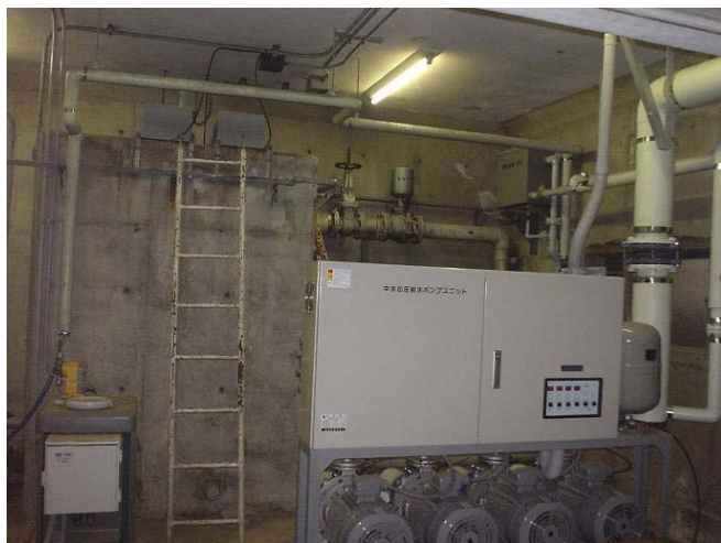
水再利用設備（中水設備）
