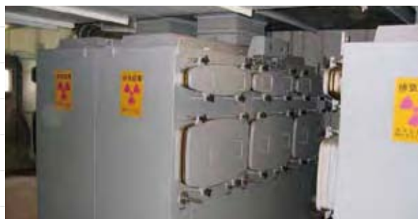
RI施設排気施設
