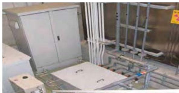
RI施設排水設備
