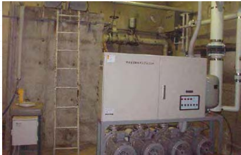
水再利用設備（中水設備）
