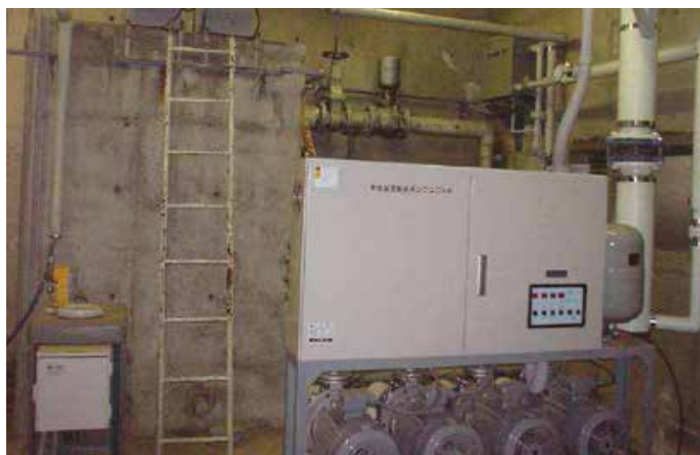
水再利用設備（中水設備）
