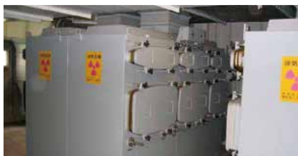
RI施設排気施設
