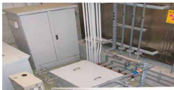
RI施設排水設備
