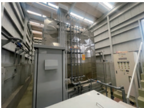
RI 施設排水設備
