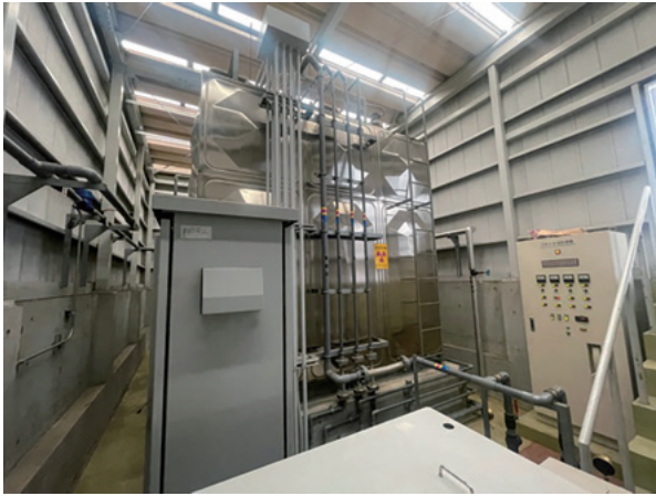
RI 施設排水設備
